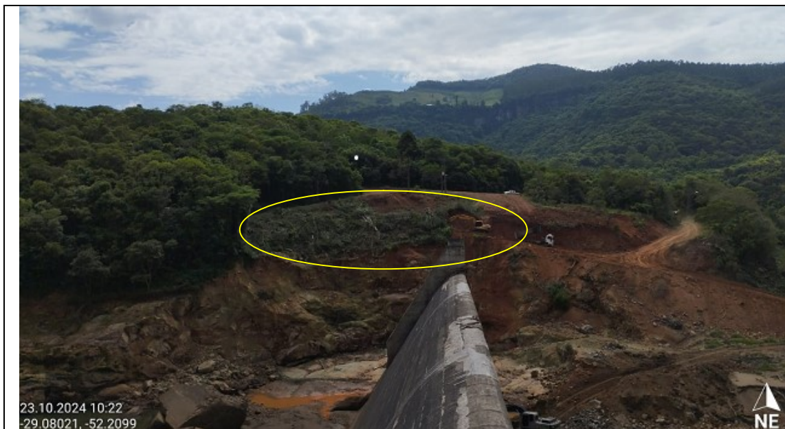
FIGURA 4. Supressão realizada na ombreira direita em área instável, com riscos de deslizamento .
