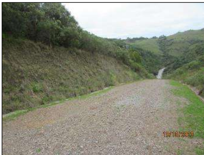
Figura 17 - Talude ao lado esquerdo do acesso à casa de força também está parcialmente vegetado e aparentemente estável.
