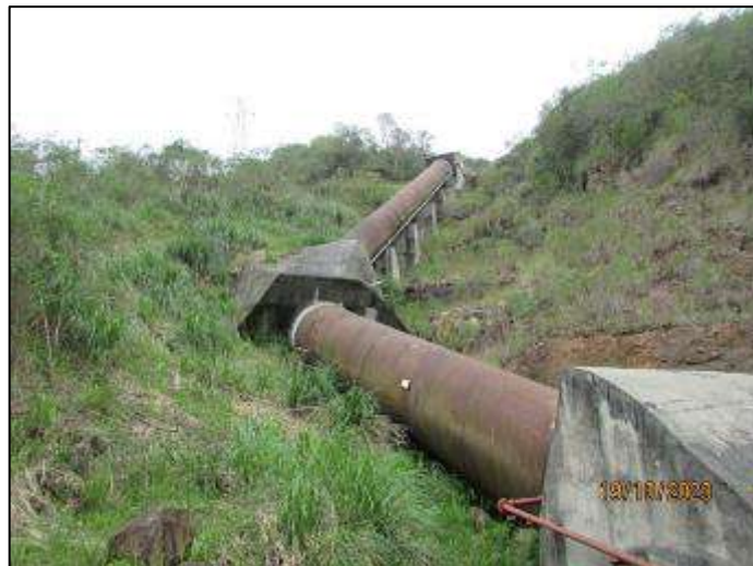
Figura 23 - Talude em ambos os lados da tubulação não apresenta pontos instáveis, mas necessita de monitoramento constante.
