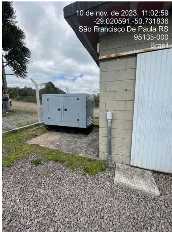
Figura 33 – Gerador ao lado da sala de controle da “tomada d’água”
