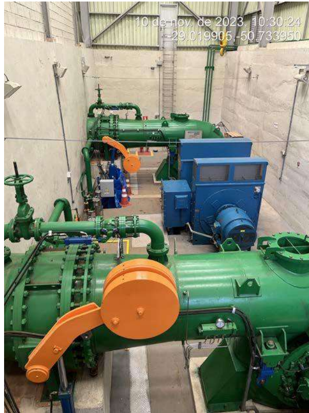
Figura 8 – Visão geral do interior da casa de força
