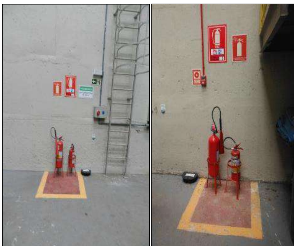
Figura 10 – Extintores de incêndio, mantidos no interior da casa de força.
