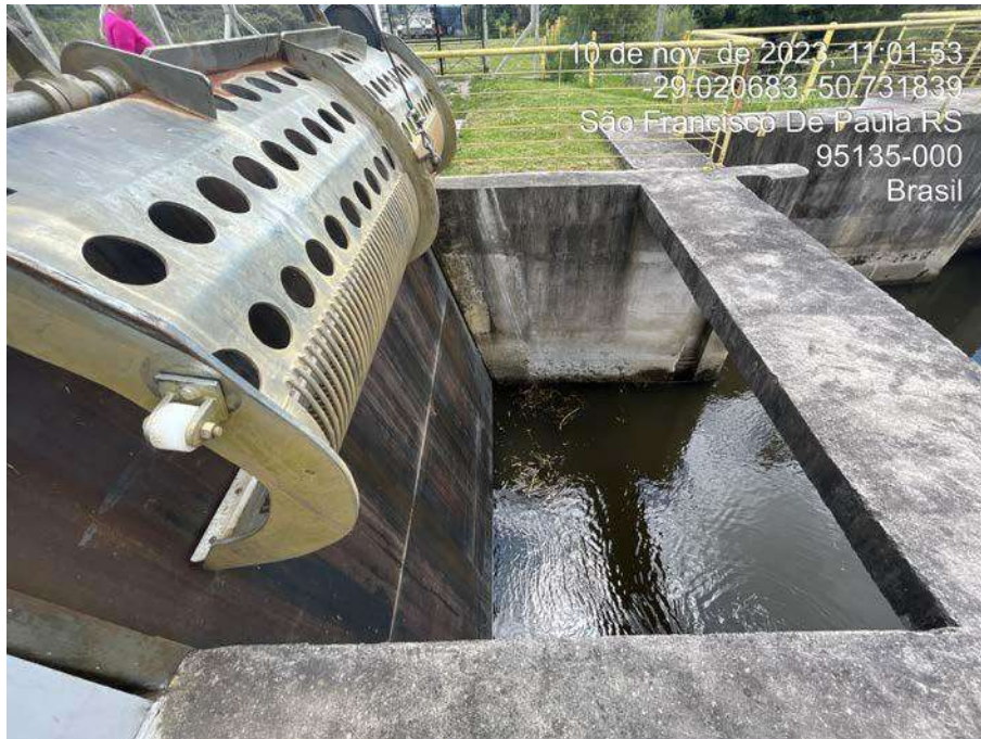
Figura 29 – Visão geral do limpa-grades
