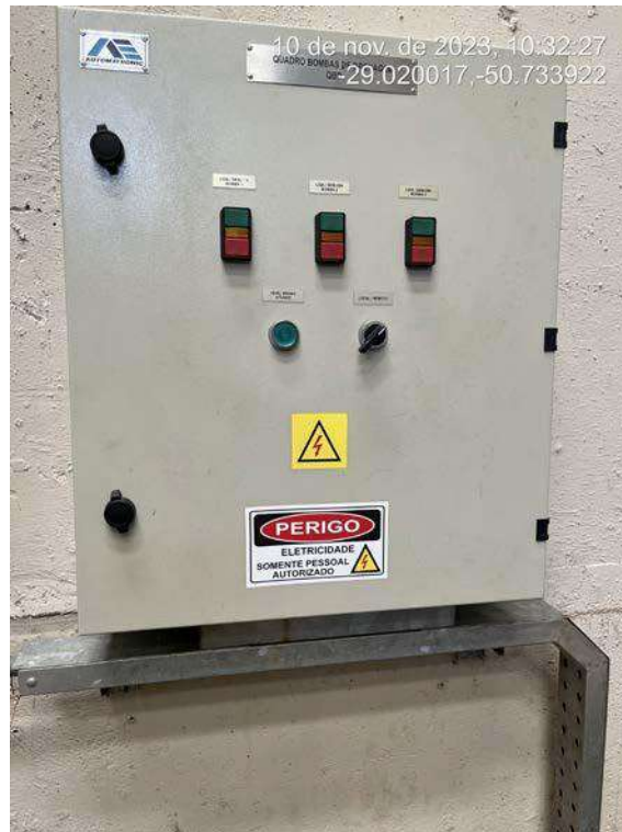
Figura 13 – Quadro controle das bombas do poço de drenagem
