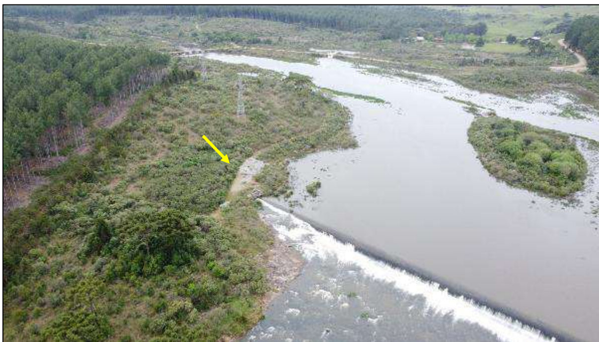
Imagem aérea 3 - Vista do barramento com seta indicando na margem direita do lago o ponto onde havia sulcos erosivos que foram estancados com a colocação de brita.
