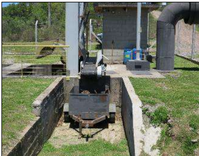
Figura 95 - Resíduos do limpa grades, armazenado temporariamente em um reboque, para posterior destinação.
