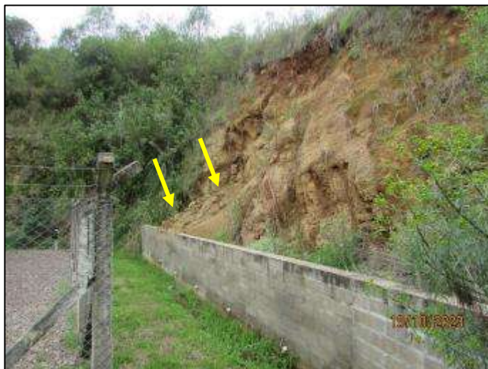
Figura 20 - Talude a Leste da SE com porção da rocha mais alterada sofrendo quedas constantes do material alterado. Nas setas, a indicação do material acumulado entre o muro de contenção e o talude.
