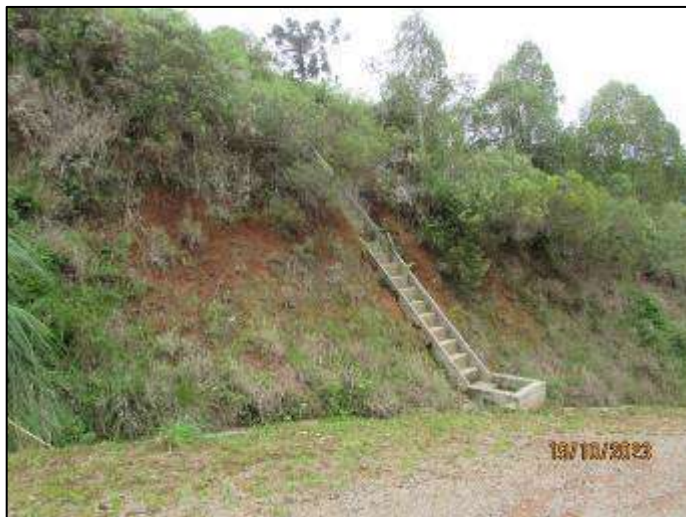
Figura 18 - Escadaria de dissipação de energia de água pluvial na face do talude.
