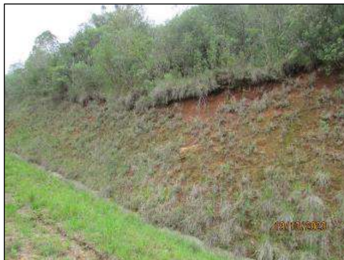
Figura 15 - Talude com vegetação rasteira e rala em alguns trechos de sua face.
