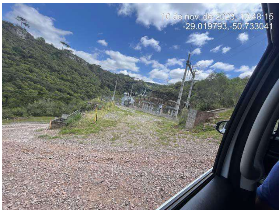
Figura 20 – Visão geral da subestação da PCH
