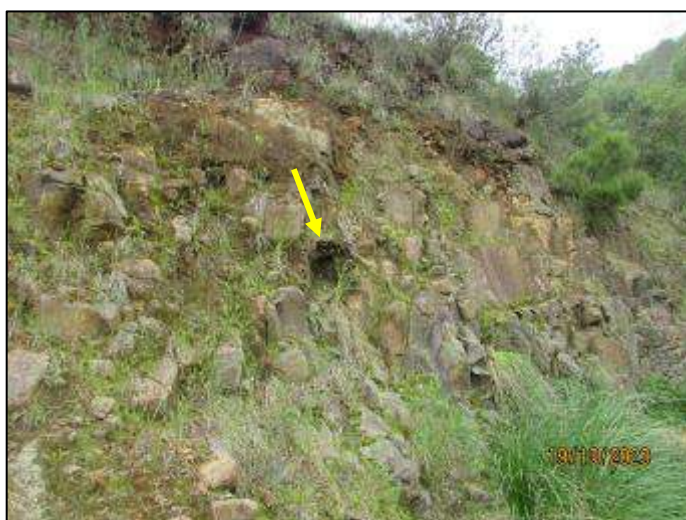
Figura 19 - Talude a Norte da SE composto basicamente por blocos de rocha com quedas desses fragmentos, onde na foto a seta indica um ponto onde houve queda recente de um bloco.
