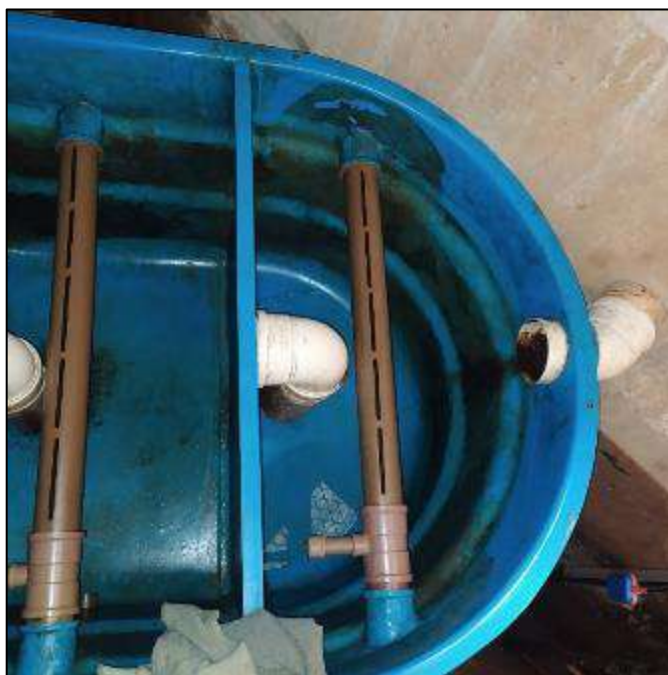
Figura 55 - Caixa de drenagem da PCH Cazuza Ferreira.
