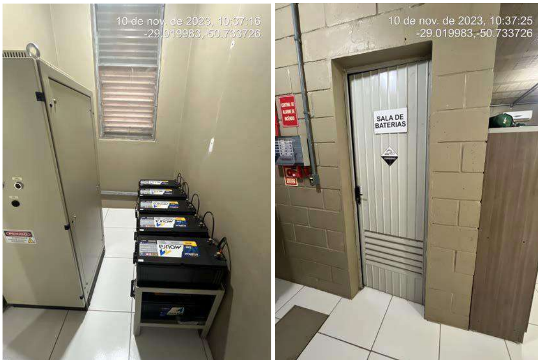
Figura 18 – Visão geral da sala de baterias – casa de força
