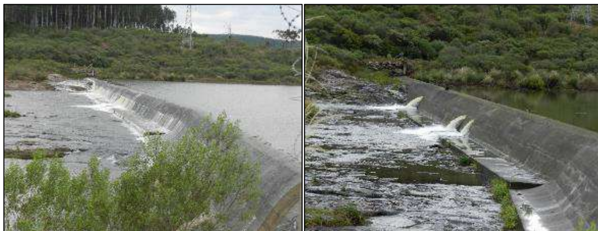
Figura 2 – Dispositivos de manutenção da vazão remanescente existentes no corpo da barragem, em pleno funcionamento, verificados durante o ano de 2023.
