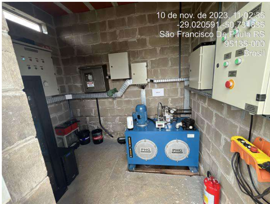
Figura 32 – Visão interna da sala de controle da “tomada d’água”
