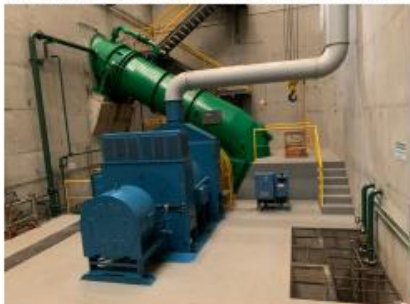
Figura 09: Vista do gerador, turbina e entornos sem indícios de vazamentos
