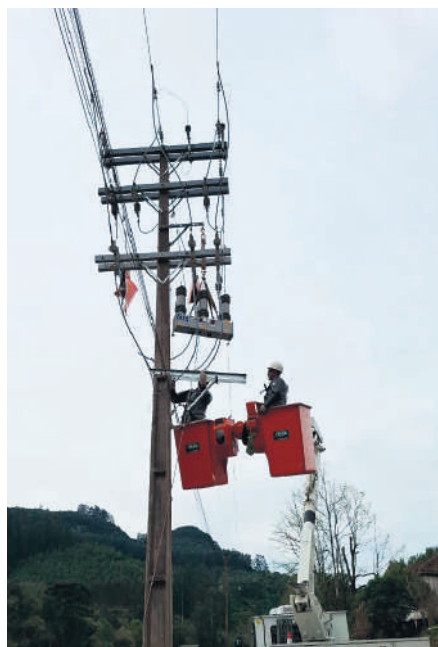
São instalados 21 religadores automáticos e telecomandados
