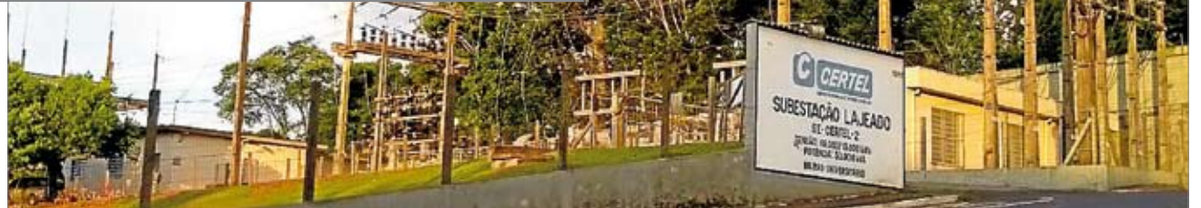
Subestação de Lajeado recebe constantes investimentos para alavancar o fornecimento de energia a Lajeado e ao Vale do Taquari
